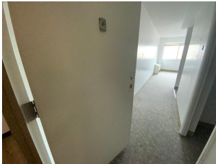
Missing Door Knob
