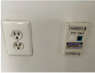
LAN & VoIP System 67080
